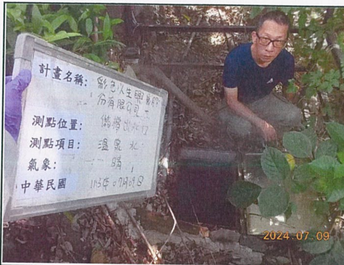
內容: 儲槽出水口
