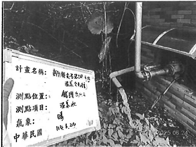
內容: 儲槽出水口
