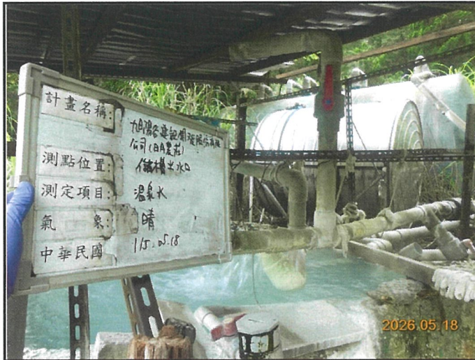
內容: 儲槽出水口
